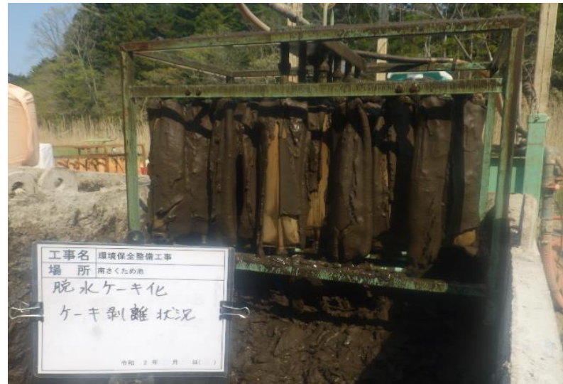
⑥脱水ケーキ化 ケーキ剥離状況
